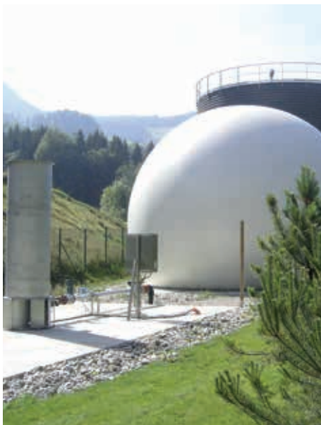
■ Ce méthaniseur permet de produire du biogaz.
