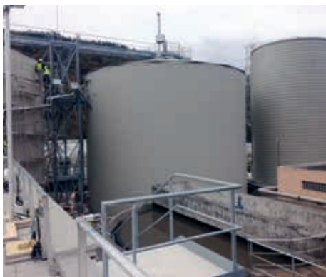
■ La fin des travaux de la station d'épuration de Besançon est prévue en mars prochain.
